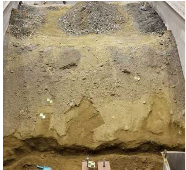
写真 5-9 1 段タイプ側法面の損傷状況
