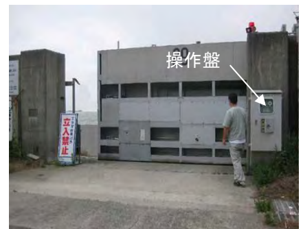
写真 5.4 陸閘の電動化（尼崎西宮芦屋港）
