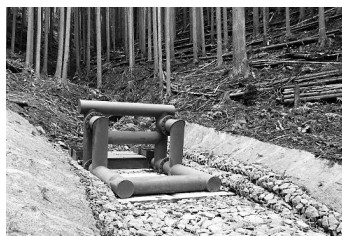
簡易流木止め施設
