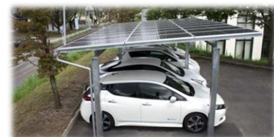
(PPA方式による太陽光発電設備例)
