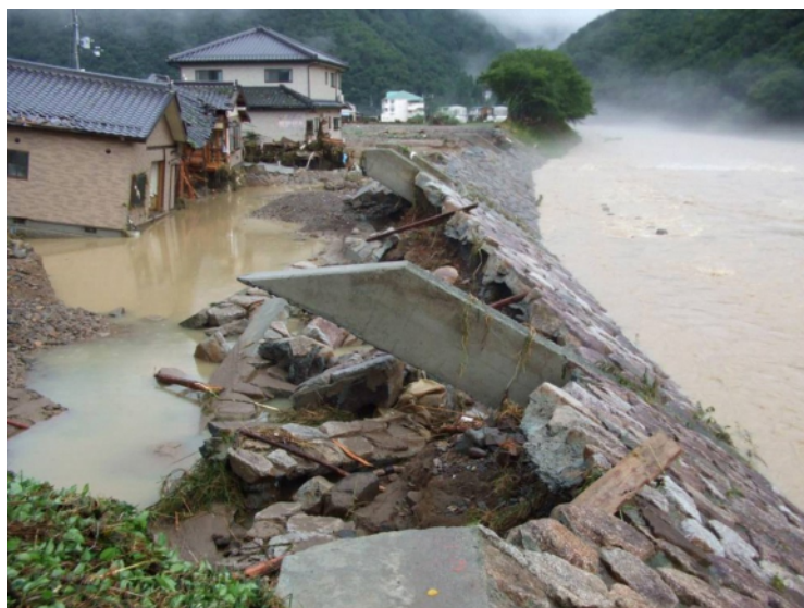
【台風 9 号災害現場】
