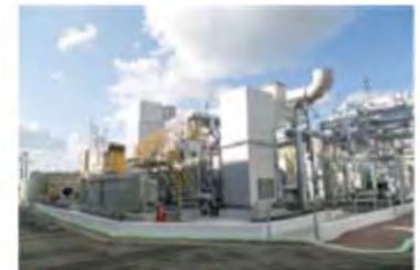
水素コージェネレーションシステムのプラント
