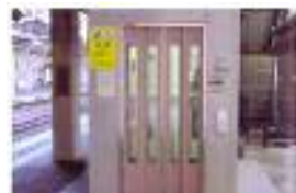
駅舎車いす対応エレベーター
