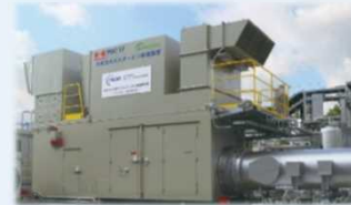
水素コージェネレーション 実証設備
