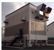
非常用自家発電設備のイメージ
