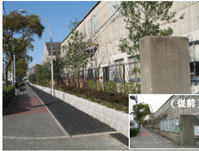
住友金属工業(株)様の事例 既存の工場の塀を一齐に撤去し、緑化空間として生まれ変わらせた。植樹は尼崎 21 世紀の森づくり協議会と協働で行った。沿道緑化推進モデルとして看板の設置も行った。
