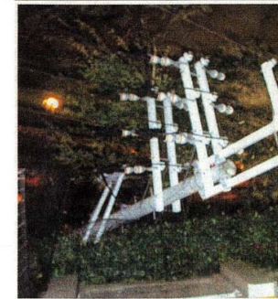
道路陥没で倒れた電柱（午後8時15分ごろ、西宮市生瀬武庫川で）
