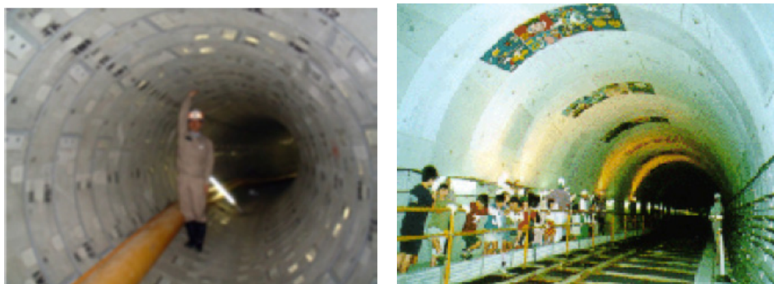
図 5-10 雨水貯留管（左：西宮市、右：伊丹市）
