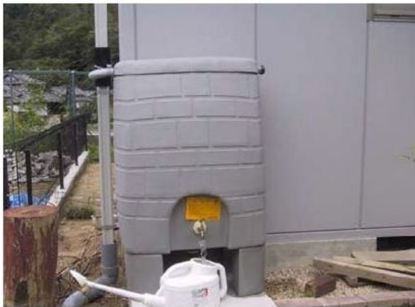
雨水貯留タンク
