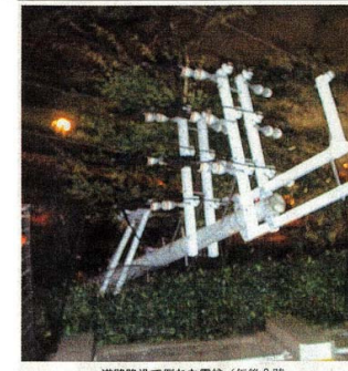
道路陥没で倒れた電柱（午後8時15分ごろ、西宮市生瀬武庫川側で）
