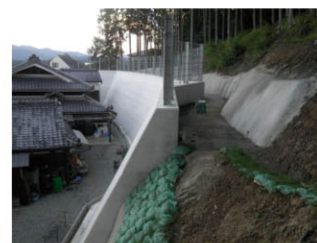
落石防止柵（川西市笹部）
