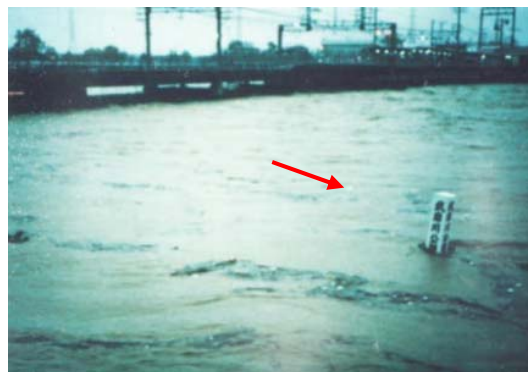
写真 2.1.7 昭和58年災害（阪神電鉄橋梁付近）
