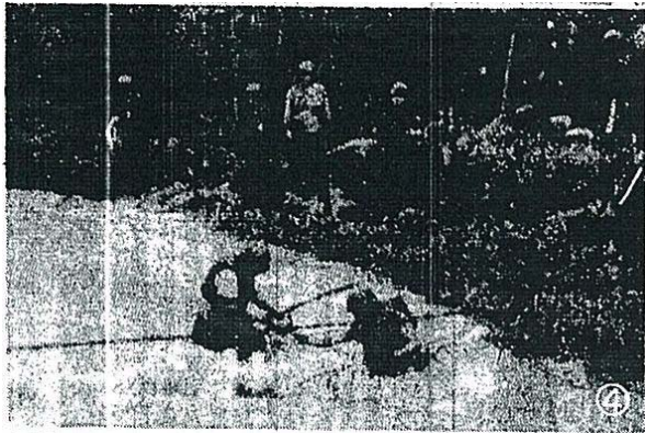
写真7 伊丹・天神川堤防の補強工事に活躍する自 衛隊員 (読売新聞(阪神版) 昭和36年6月27日)
