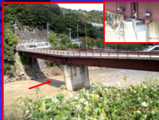
橋脚が傾く森興橋
