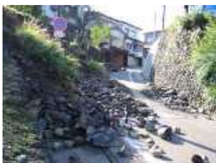
地震によるブロック塀・石垣の崩壊
