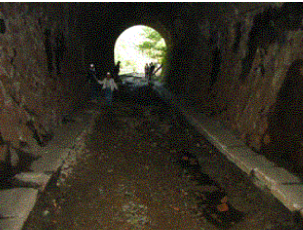
長尾山第1トンネル内部流失（上流側）
