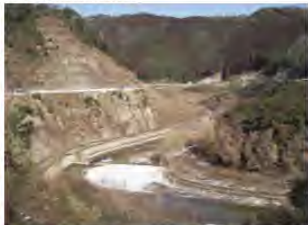
低水流量観測設備付近
