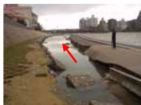
(見返り岩下流) 洪水により被災した高水敷
