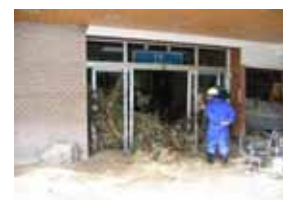
洪水により旅館玄関に押し寄せた土砂等
