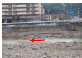
(生瀬大橋下流) 洪水により崩壊した護岸の根元
