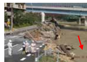
(生瀬大橋上流) 洪水により崩壊した護岸及び道路
