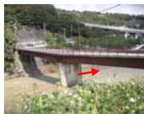
洪水によりひずんだ森興橋
