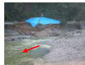
(見返り岩上流) 洪水により崩壊した護岸及び道路
