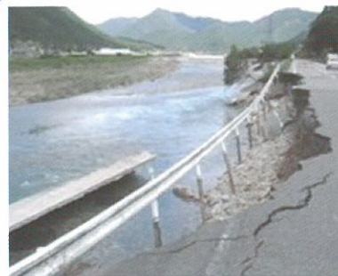
平成23年台風12号による被害 (加古川水系杉原川:多可町)
