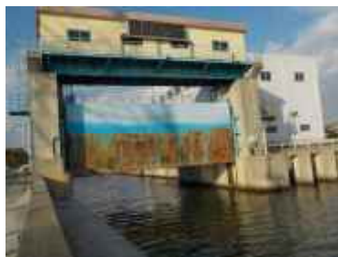
妻鹿漁港 白浜排水機場
