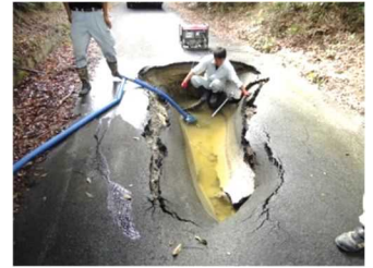
幹線パイプラインの破損 (断水・通行に支障)
