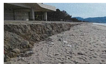
古津路海岸 侵食被害状況 （南あわじ市）
