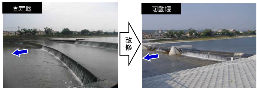
洪水を安全に流下させる可動堰へ改修（三木市 高木井堰）
