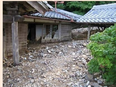
←平成26年豪雨時の被災状況
