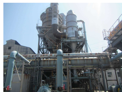
木質バイオマス発電所（赤穂市）
