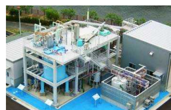
下水汚泥からリンを回収する施設（神戸市）
