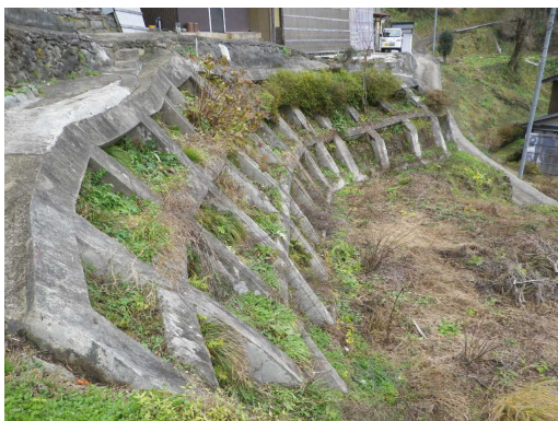
アンカー工が変状するなど災害防止機能が低下（対策前）
