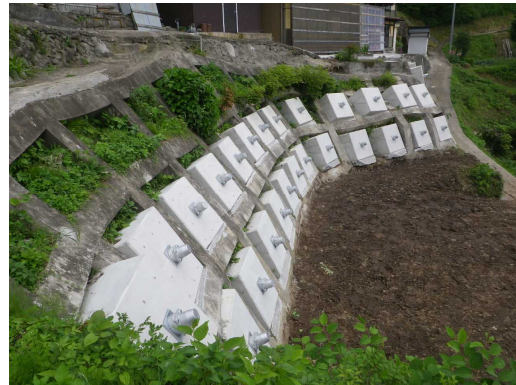
アンカー工を増設することにより災害防止機能を向上（対策後）
