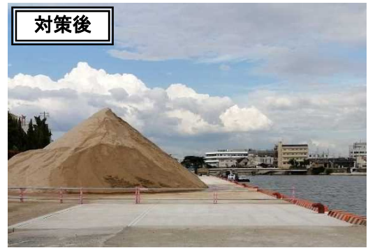
【伊保地区(-3.5m 物揚場 床版欠損)】
