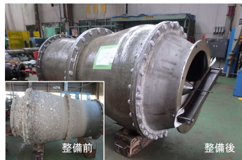
【相生港海岸(旭排水機場)】
