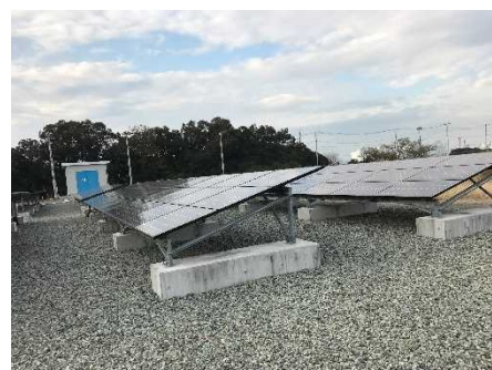
武庫川下流浄化センター 太陽光発電設備
