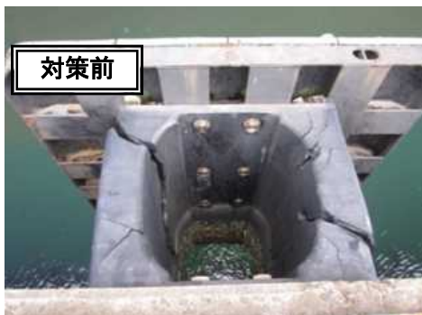
【播磨地区(-12m 岸壁 防舷材損傷)】
