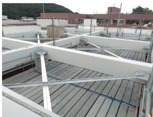
耐震水平ブレース設置等による受変電棟耐震化(加古川上流 王子ポンプ場)
