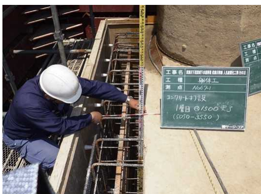
人孔外面のコンクリート増厚補強による人孔耐震化(武庫川下流流域下水道)
