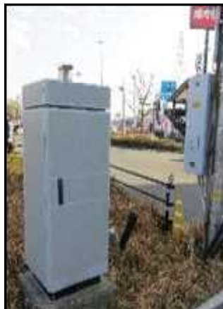
【自動起動式信号機電源付加装置】
