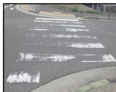
【摩耗した横断歩道】
