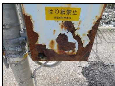
【腐食した信号制御機】
