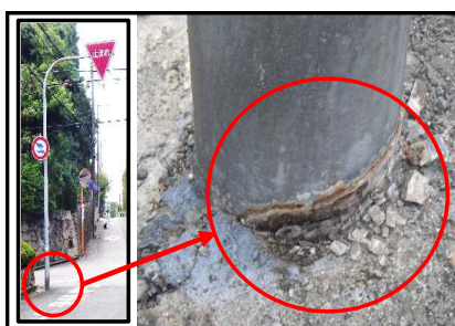
【腐食した大型標識柱】
