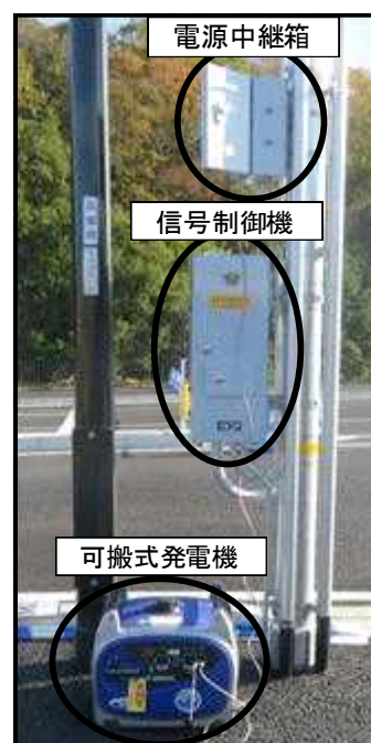
【信号機電源中継箱接続状況】
