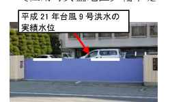
[佐用中央病院] 浸水防止扉
