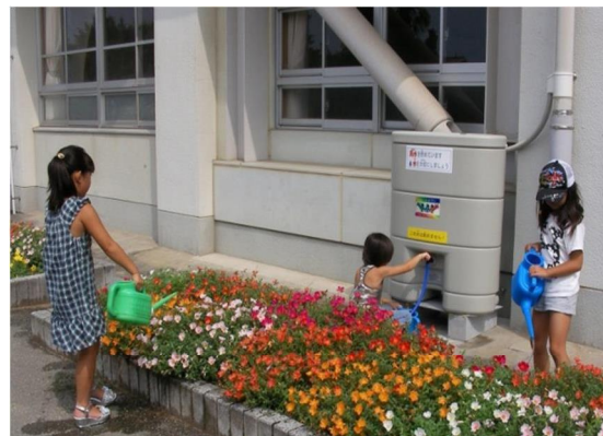
姫路市の小学校に設置されている 雨水貯留タンク
