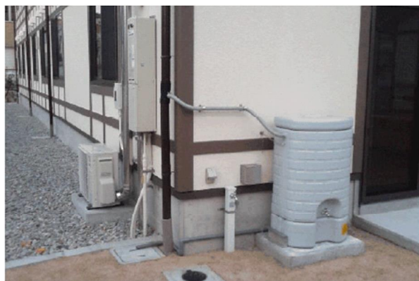
姫路こども家庭センターの 雨水貯留タンク
