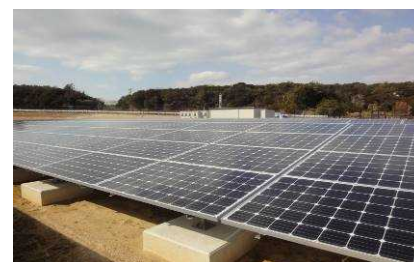
住民参加型くにうみ太陽光発電所
