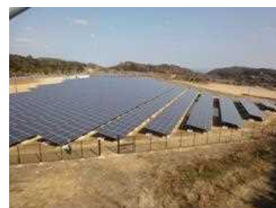
住民参加型太陽光発電所
