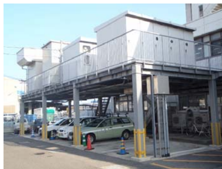
図 45 淡路県民局の自家発電設備の高層階設置
