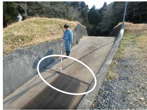
放水路部 漏水
