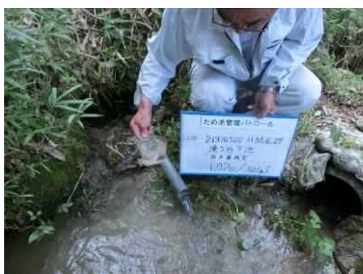
後法 漏水量測定(遠景)
