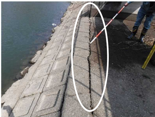
洪水吐流入部 ひび割れ
