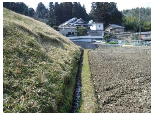
後法 はらみだし及び陥没
