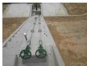
取水施設(斜樋)
