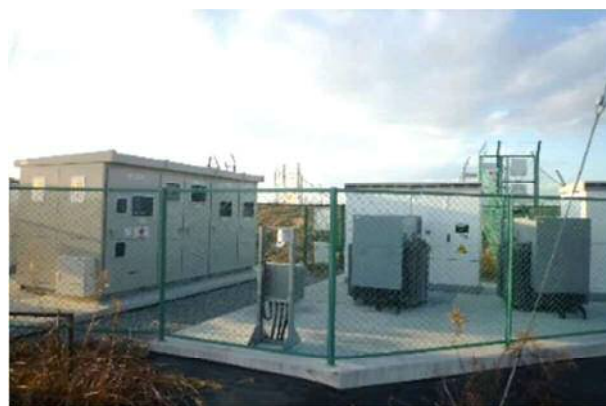
変電設備における侵入防止柵
